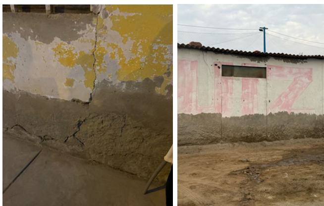
Figura N°02: Fotografía mostrando la estructura exterior dañada de una vivienda del sector.
