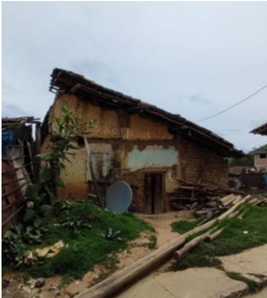
Figura 11 y 12. Fotografías de viviendas dañadas
